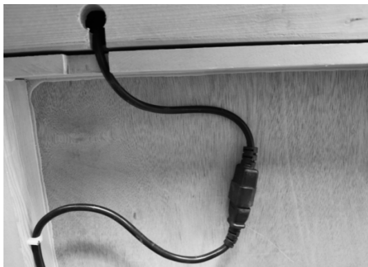
(1) Conectați fișele cablurilor de încălzire și asigurați-vă că cablurile nu sunt ciupite
